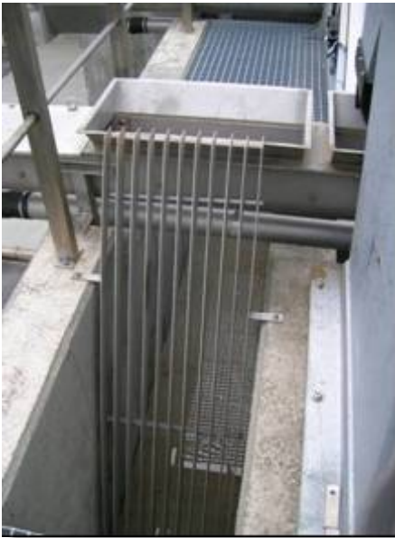
Reja de gruesos de limpieza manual. (Su longitud no debe exceder lo que se pueda rastrillar fácilmente a mano).
