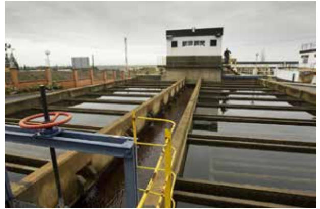
Instalaciones de Gihasa en Huelva. JULIÁN ROJAS
